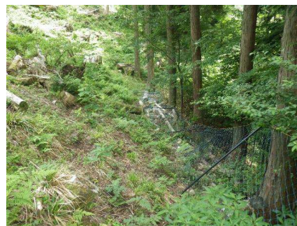
積雪による支柱の折損
