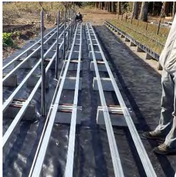
コンテナ設置台
