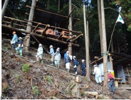
架線集材箇所の集材機
