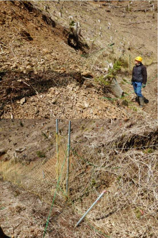
積雪や土砂移動等による補助支柱の傾斜
