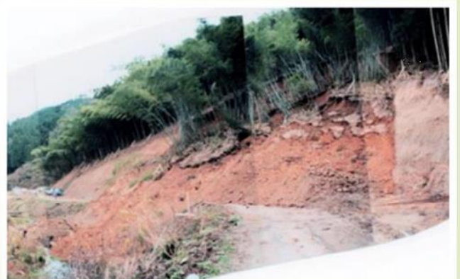
移動体脚部の切土から崩壊した事例
