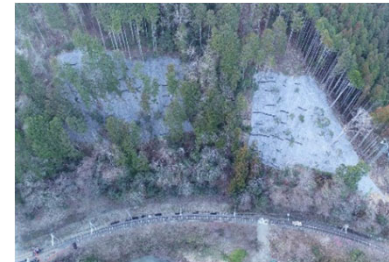
完成写真（直下に住宅や鉄道、道路、観光地がある中、適確な施工管理、工程管理により、安全かつ丁寧に施工された。）
