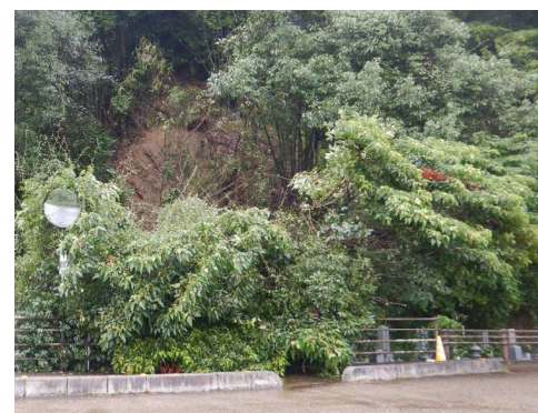
山腹被害状況（城山国有林）
