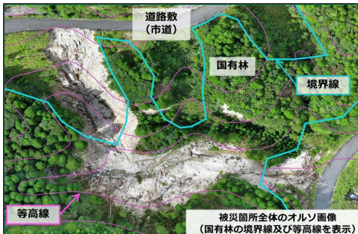
【被災箇所全体のオルソ画像】
