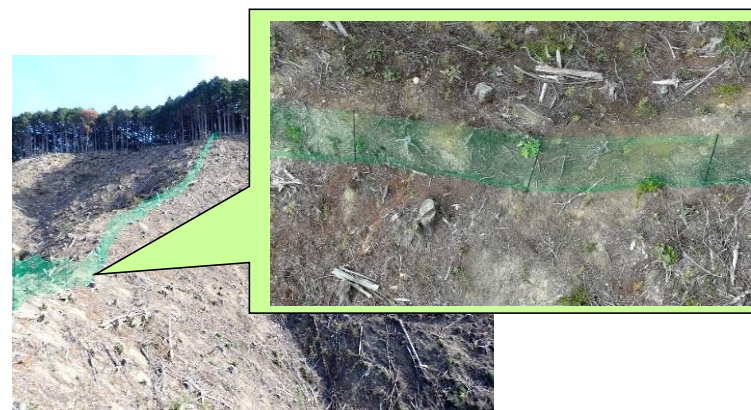
【アニマルネットを使用した防護柵 R7.12】 たかとりやま (高市郡高取町 高取山国有林)
