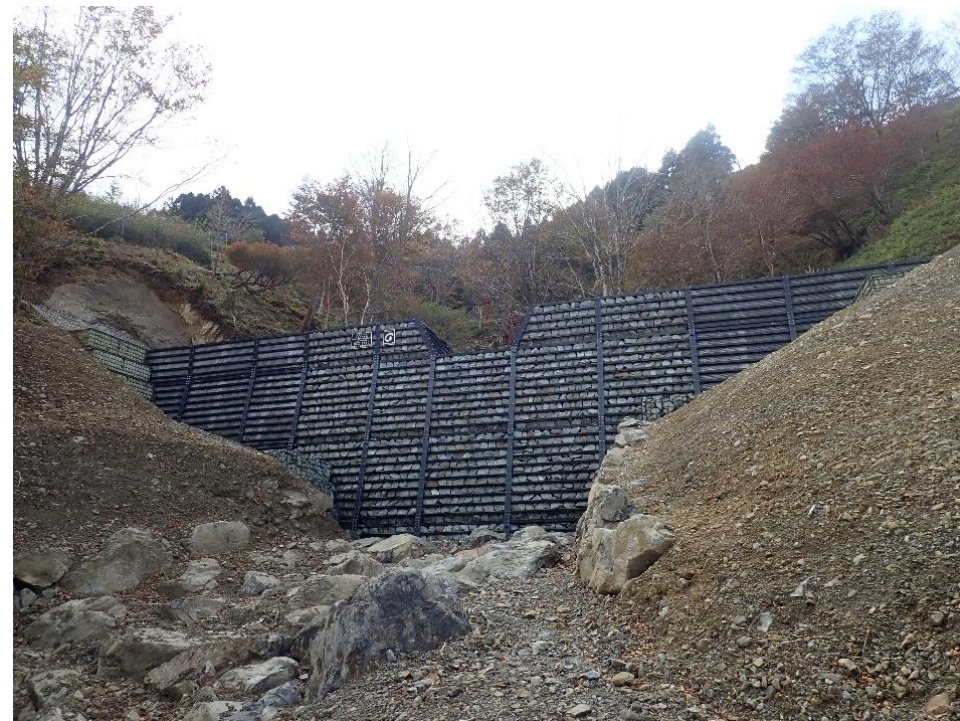
鋼製谷止工（5年度施工）
