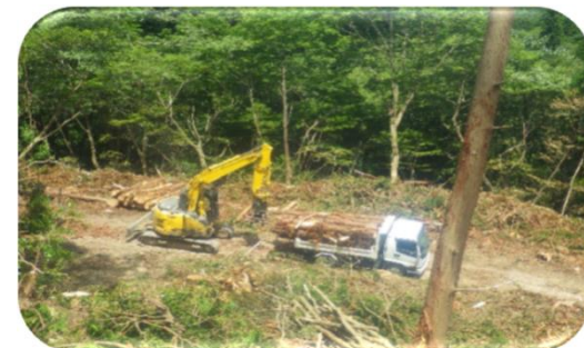
令和4年度主伐箇所から搬出する木材 (敦賀市 黒河山国有林)
