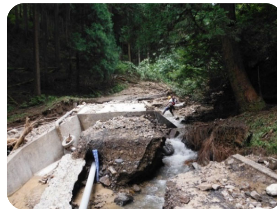
職員派遣による林道被害調査 (南越前町 民有林林道)
