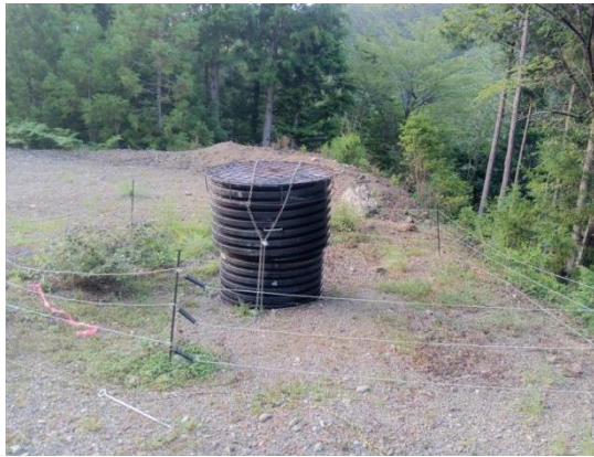
写真4 大型排水管(ポリエチレン管)
