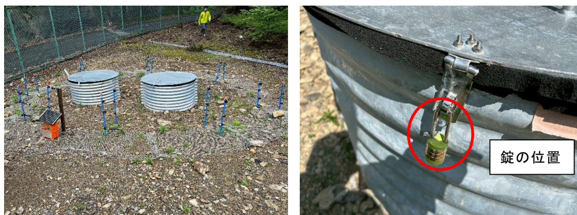
図 2-4 大型排水管（左：遠景、右：錠の位置）
