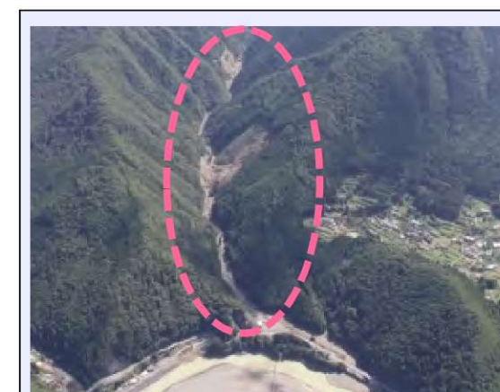
高津工区（被災直後） ・崩壊規模 2.67ha ・対策：谷止工、山腹工 (平成30年度工事完了・移管済)
