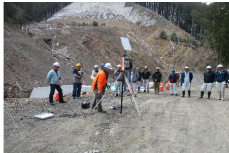
スターリンクの設置状況
