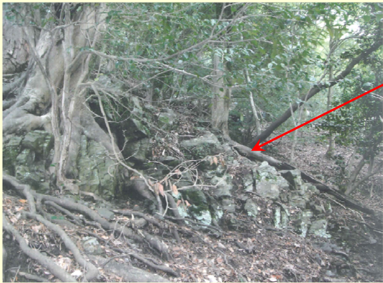
広い範囲で露岩し、亀裂が発達しているため落石の危険性がある。
