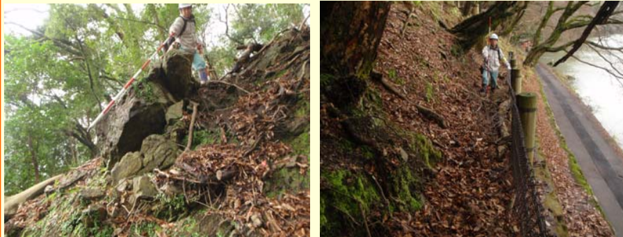
落石の危険性及び対策工の現況
