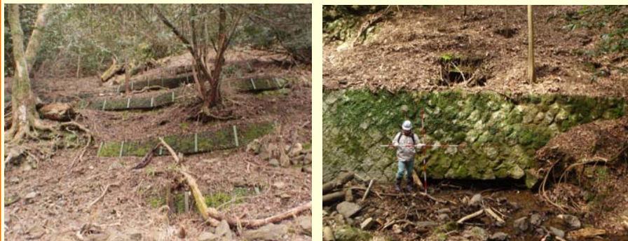
既存施設の老朽及び破損状況
