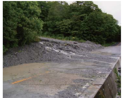
山麓の環状道路に流れ出した土砂は、通行止めを引き起こします。
