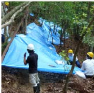
クラックへのブルーシート設置
