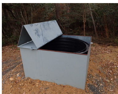
大型排水管（外観から見た構造）
