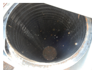
残渣処理施設の内部
