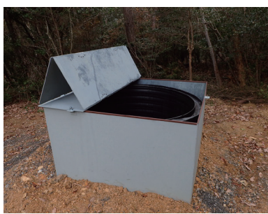
大型排水管（外観から見た構造）
