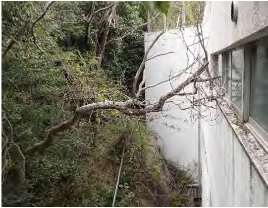
写真 - 1 近隣施設への倒木 (劔谷国有林、芦屋市)
