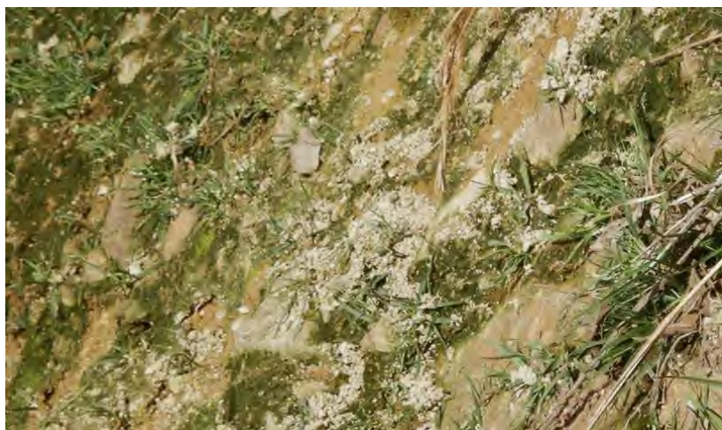
写真－6 表土の剥離による崩落
