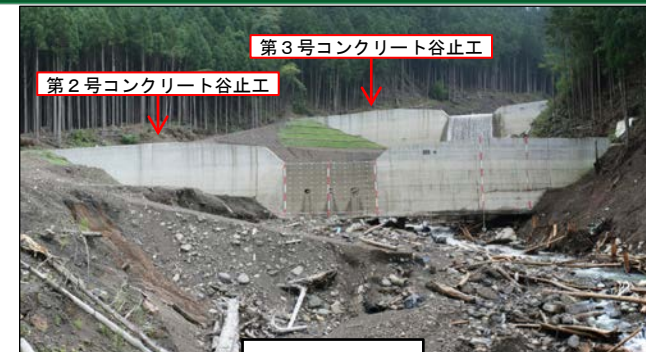
被災後の状況
