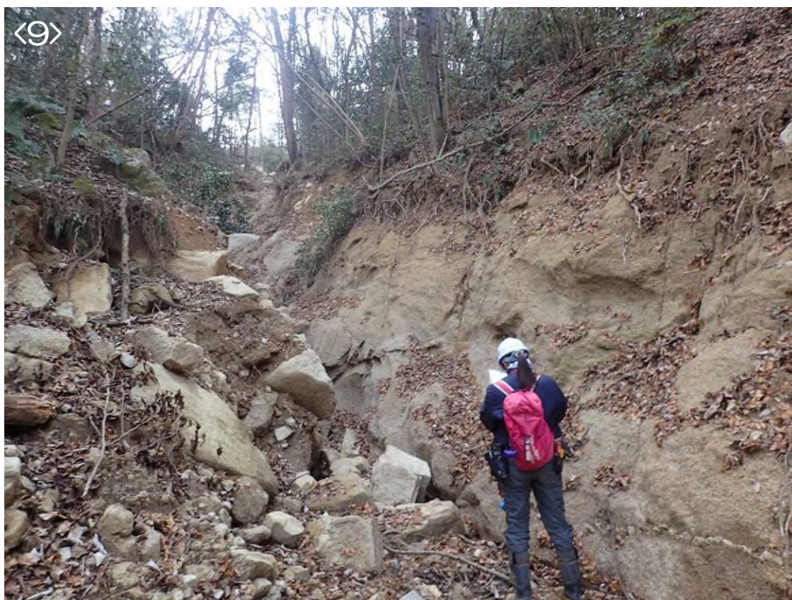
写真 13-10 巨礫を含む溪床堆積物の侵食
