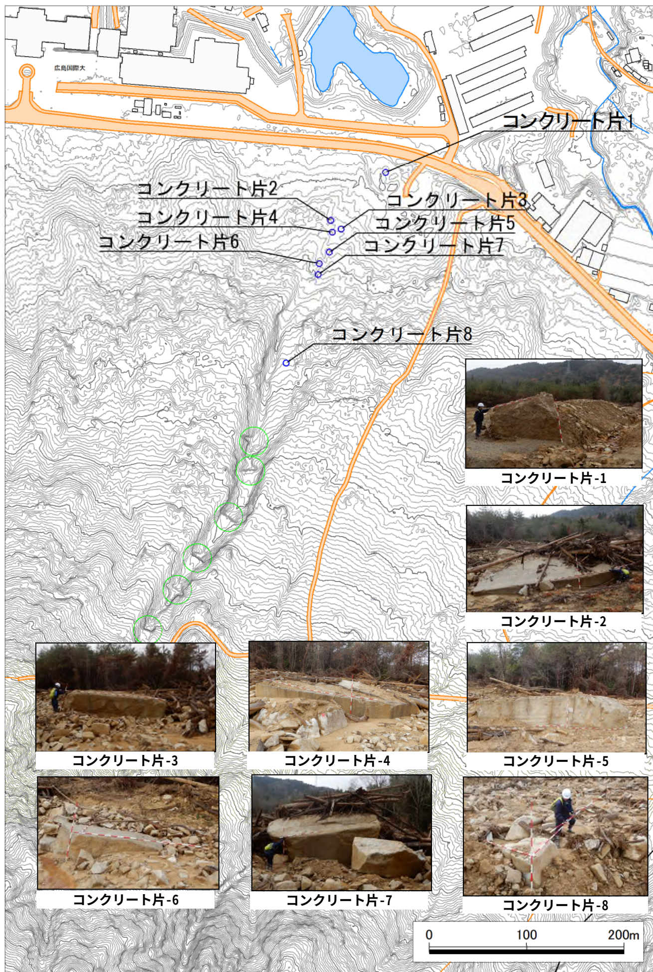
図 19 黒瀬区域における破損既設治山ダム
