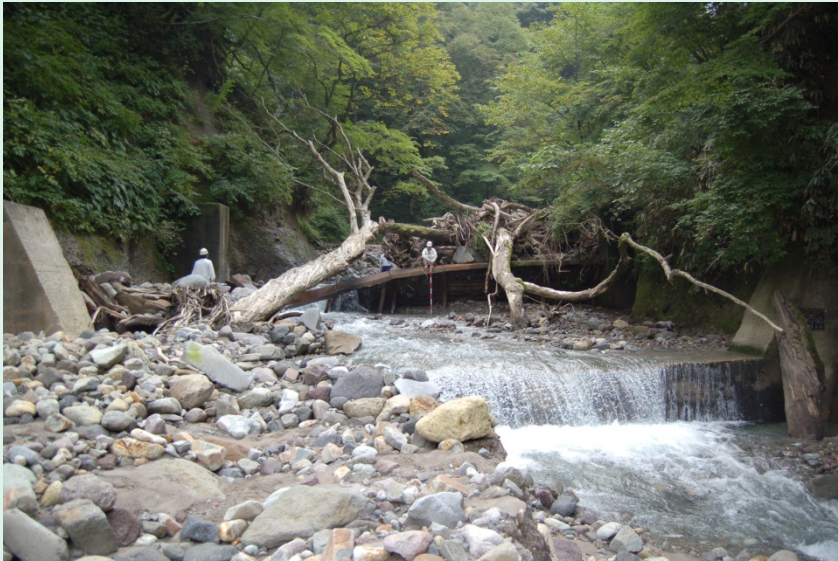
堰堤被災状況
