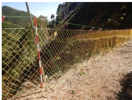
上張りワイヤーの防護柵 全景 あじやり 【阿舎利国有林（栄栗市）】
