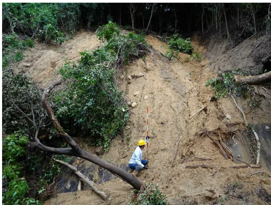
【工事前の荒廃状況】
