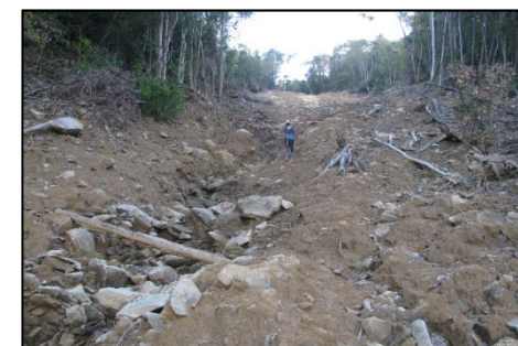
【被災状況】 高屋30
