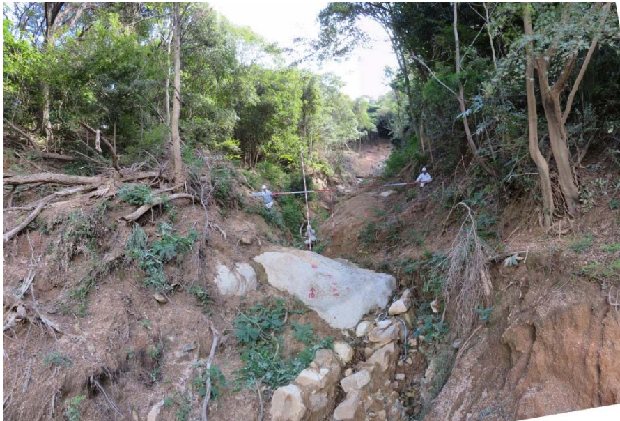
【工事前の荒廃状況】
