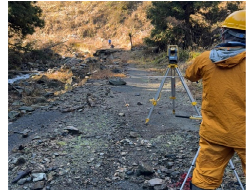
民有林林道（併用林道）被害調査の様子 (南越前町：民有林)
