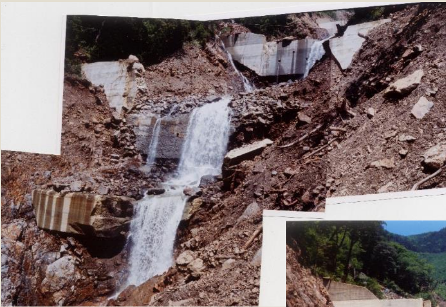
土石流等により破壊 された治山ダム
