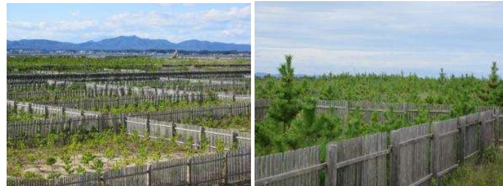
東日本大震災で津波被害の松川浦海岸防災林の復旧・再生
