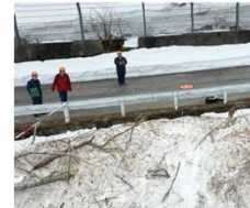
ドローンによる雪崩発生状況の調査
