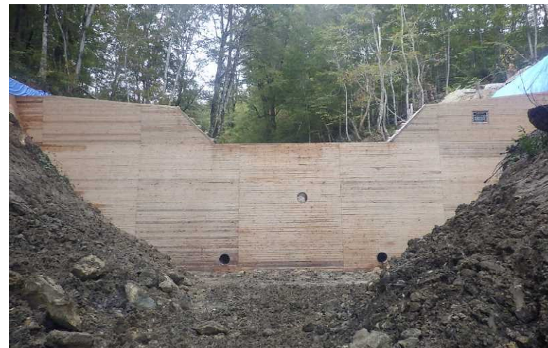
治山丸太残存型枠（会津署）
