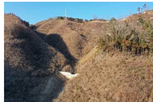
邊栗地区の崩壊箇所及び溪間工施工状況 （ドローンによる空中撮影）
