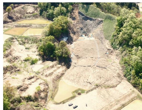
上山区域の被災状況（H31）
