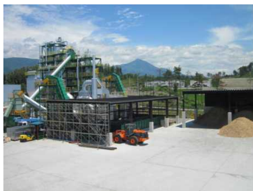
木材チップ専焼発電所
