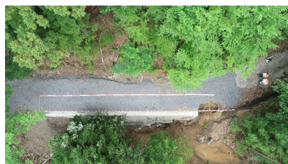
ドローンによる被災状況調査
