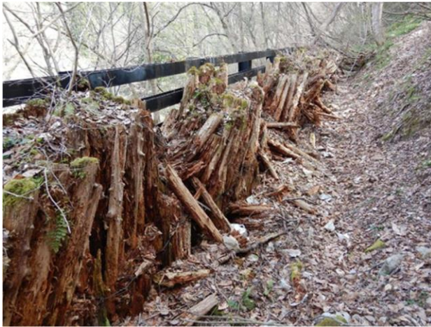
緩衝材の腐朽状況（撤去前）
