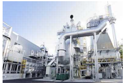
那珂川バイオマス発電所
