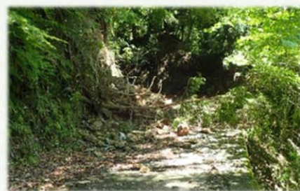
降雨により法面の一部が崩壊し土砂が流出した林道
