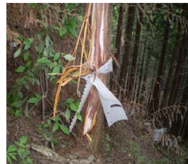
対策箇所での被害の様子
