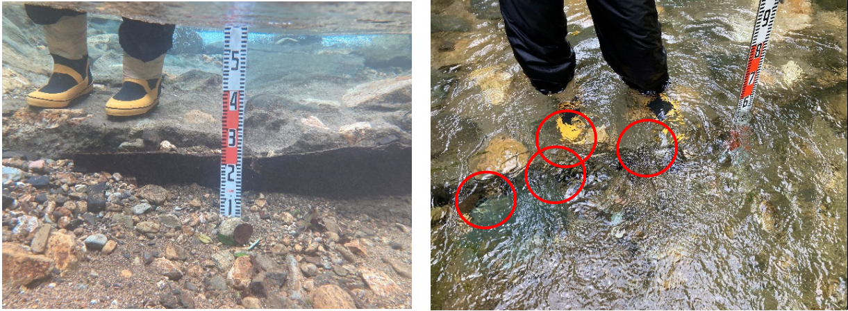
図4. 1-5 No. 5-1ダム末端部の洗堀状況（2021年8月10日撮影） 左：侵食状況 右：湧水の状況
