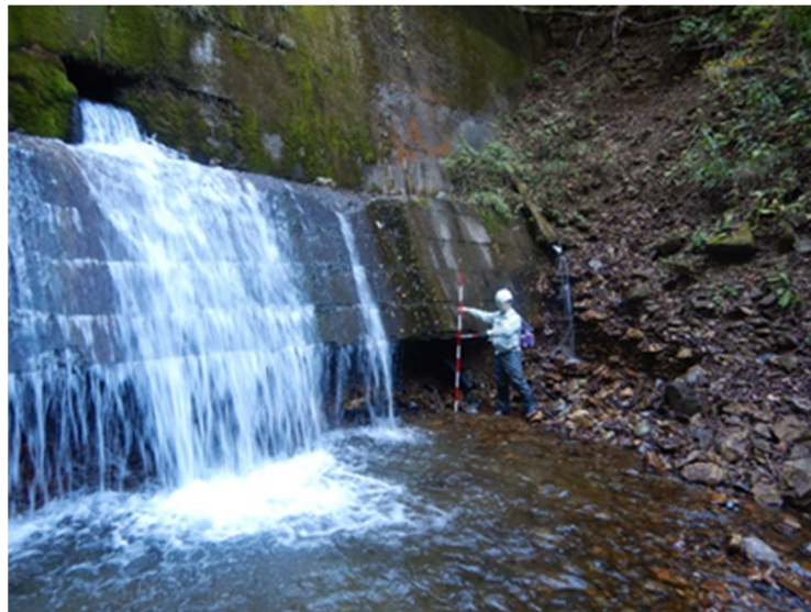
図4. 1-4 No. 6ダム副堤の洗堀状況（2021年10月29日下流側から撮影）
