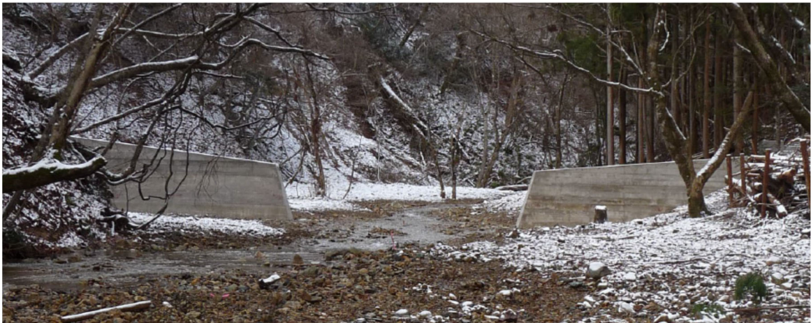
図2. 3-6 2009（平成21）年に新設した保全工（H25茂倉沢事業概要より転載）
