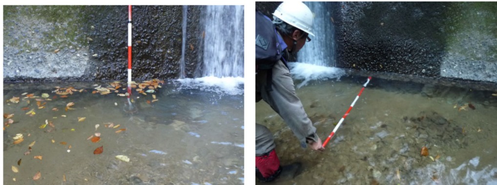
図2. 3-4 No.1ダム副提、40cm程度の基部の洗堀が認められた（2005年度時点 H25茂倉沢事業概要より転載）
