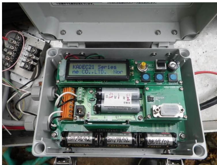
写真 2-2 No.1ダム右岸側袖部に設置しているデータロガー一部
