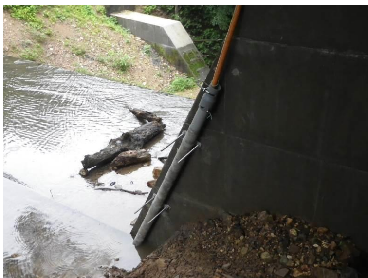
写真 2-1 No.1ダム右岸側に設置している自記水位計
