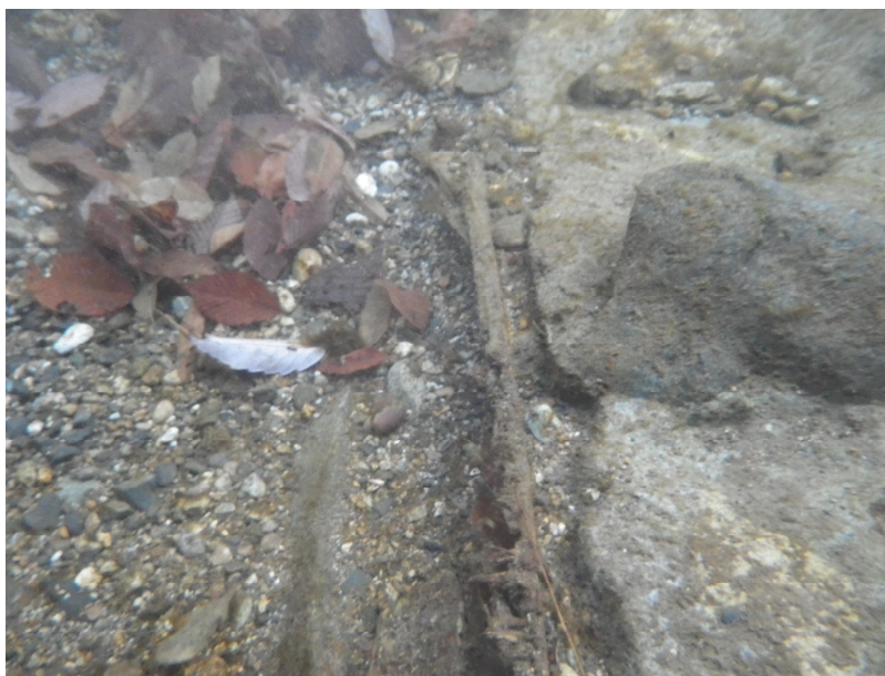
写真 6-1 No.5-1 ダムの斜路先端部の洗掘状況 (平成 25 年 12 月 2 日撮影)
