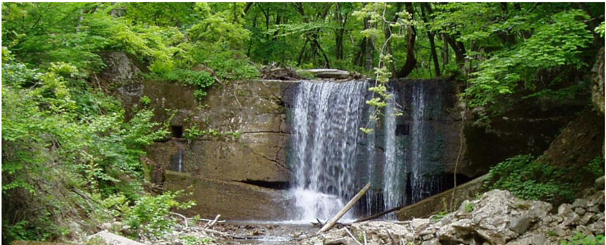
写真 2-12 No.5 ダムの損傷状況
