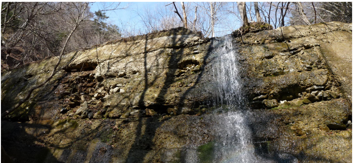
写真 2-15 No.11 ダムの損傷状況
