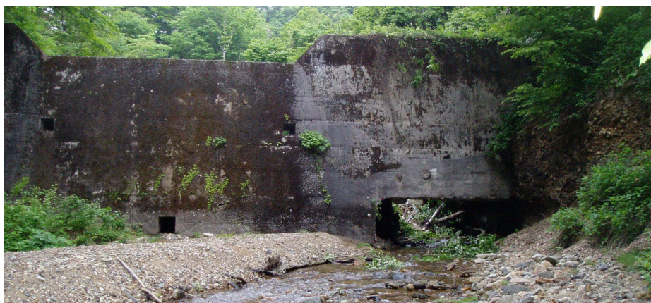
写真 2-8 No.2 ダム本堤の底抜け状況
