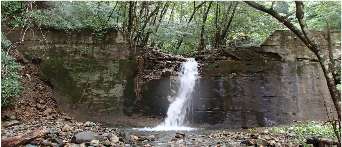
写真 2-14 No.6 ダム本堤の損傷状況
