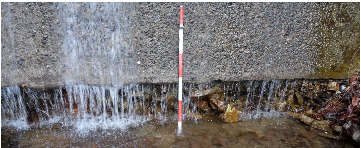
写真 2-17 No.13 ダムの洗掘状況
