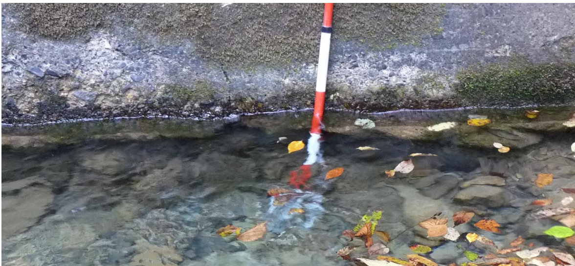
写真 2-13 No.6 ダム副堤の洗掘状況
