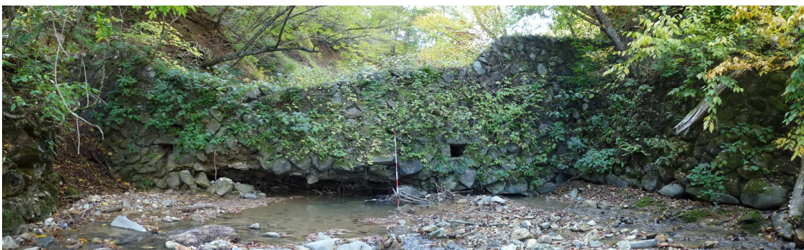
写真 2-10 No.3 ダム本堤の底抜け状況
