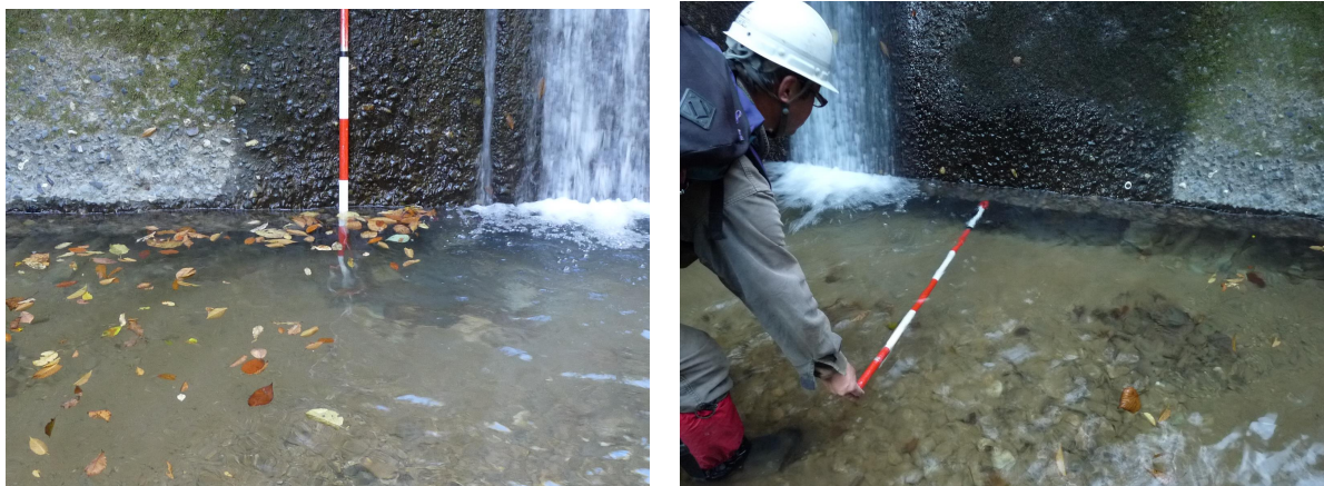
写真 2-6 No.1 ダム副堤の洗掘状況
