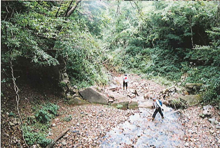
写真—23 被災したNo4ダム 倒壊したNo4ダムを上流 側から見る
