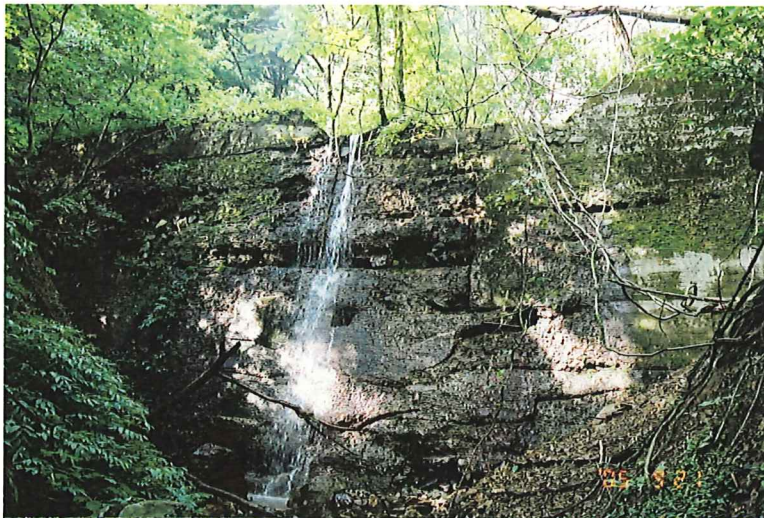
写真一19 支流の No11 ダム 老朽化が著しい。
