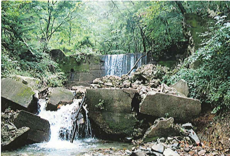
写真—22 No4・No5 ダム No5 ダムの補修で設置され たNo4ダムは倒壊している。
