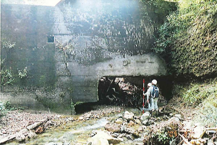
写真一14 No2 ダム（本堤） 左岸側が底抜け部分
