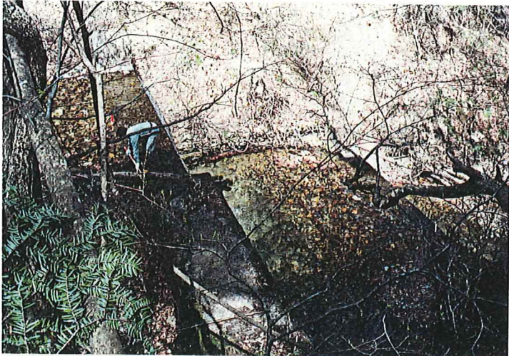
写真—31 倒壊、底抜け前の No2 ダム（前堤、本堤）
