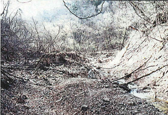
写真—32 底抜けした No3 ダムの上流側の状況
