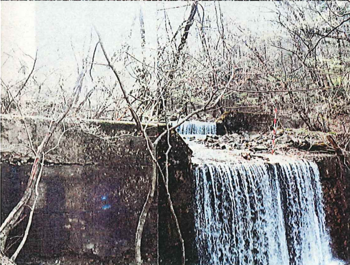
写真—33 倒壊前の No4 ダムと No5 ダム
