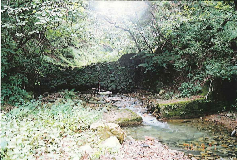
写真一20 No3 ダム（本堤・前提） 本堤は底抜け、前提は破壊
