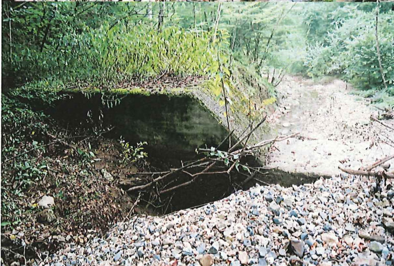
写真—29 No7 ダムの土砂堆積 比較的新しい堆積と見られる。常水はない。
