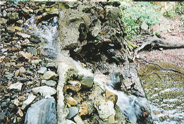
写真一27 Mo6 ダム（本堤）の天 端の破損状況
