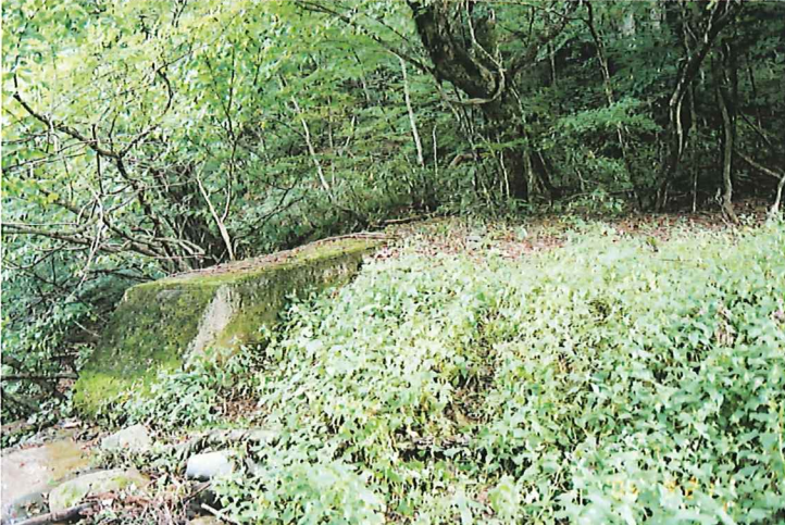
写真一12 No1 ダム（本堤） 右岸袖部上流側に堆積した土砂
