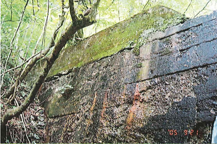
写真一11 No1 ダム（本堤） 右岸袖部の漏水、老朽化
