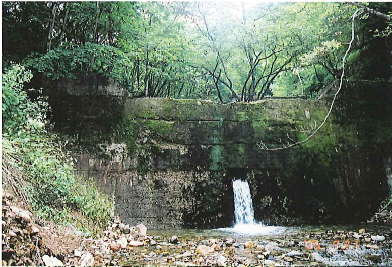
写真一25 No6 ダム（前堤） 老朽化している。
