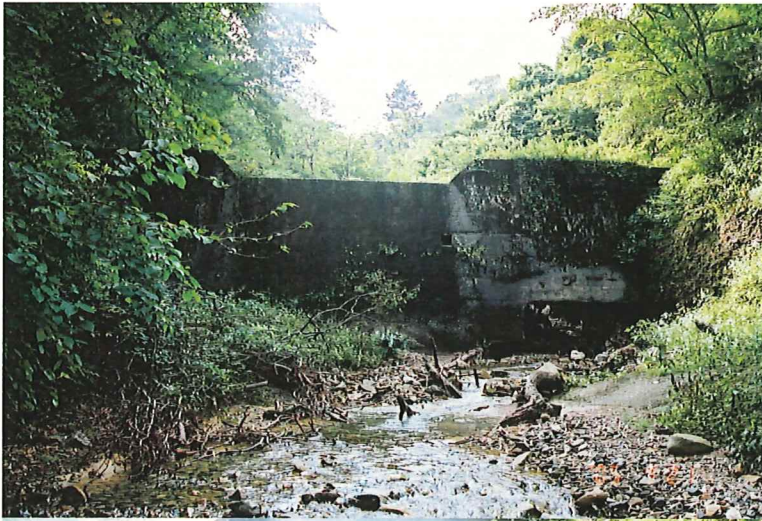
写真一13 被災した No2 ダム
