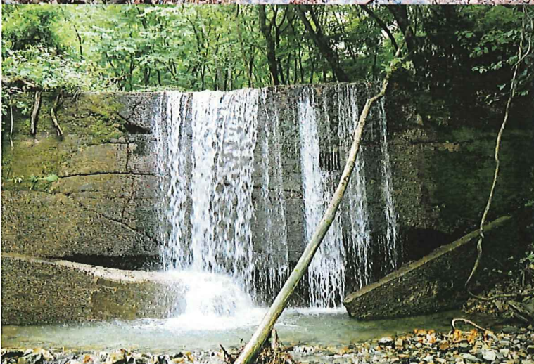
写真—24 老朽化したNo5ダム 洗掘を受けたため根固めを 施工している。補修のため に設置されたNo4ダムが倒 壊していたために、今後、 倒壊する危険性が高い。
