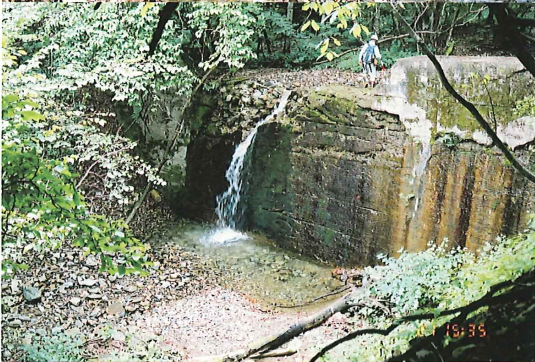
写真一26 Mo6 ダム（本堤） 天端が欠損した No6 ダム 本堤
