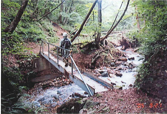
写真一5 茂倉沢下流の歩道橋（平成14年7月に流失し現在は仮橋）
