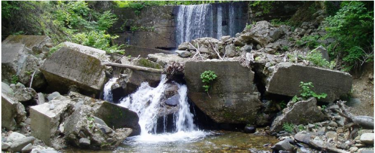
No. 4ダムの倒壊状況(奥に見えるのはNo. 5ダム)
